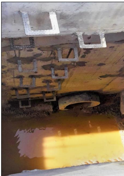
Rajah 5.2 Isu genangan air dalam lurang atau ruang pemeriksaan disebabkan ketidakpadanan aras lantai
