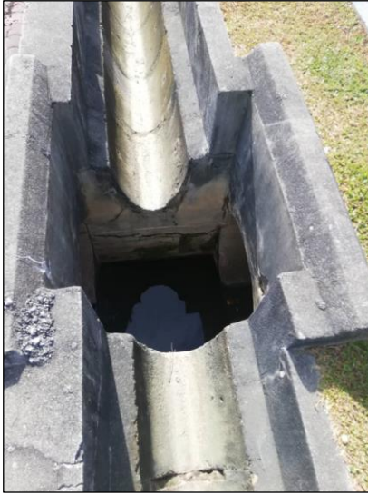
Rajah 3.4 Air bertakung dalam ruang takungan saluran akibat aras lantai yang lebih rendah
