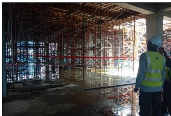
Genangan air di lantai
