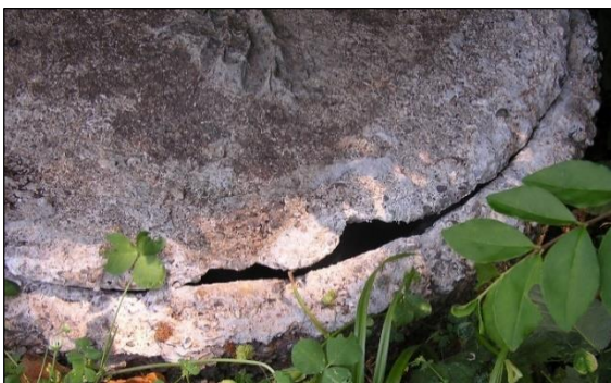
Rajah 5.3 Penutup Tangki Septik Yang Pecah
